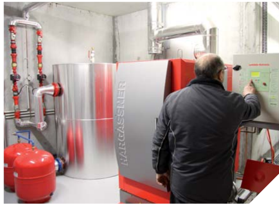
La chaufferie automatique bois de La Meilleraie-Tillay sert à alimenter en énergie la Maison de vie pour personnes âgées de la commune.
