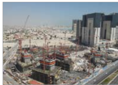
Au Qatar, les jeunes Vendéens ont filmé un immense chantier du constructeur Bouygues.
