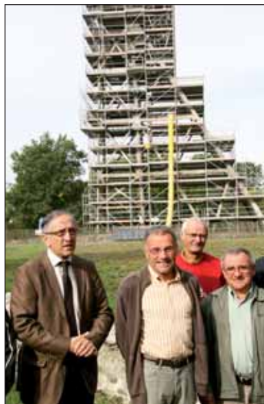
Claude Ouvrard et Jean-Guy Jourdain, maire de St Maurice des Noues, devant la tour minière lors de la visite de chantier.
