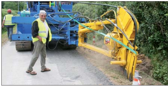
La trancheuse pose le tuyau qui recevra la fibre optique pour alimenter la zone.
