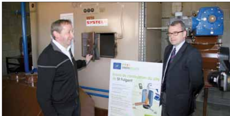
Patrick Boisseau et Wilfrid Montassier devant la chaudière à bois décheté.
