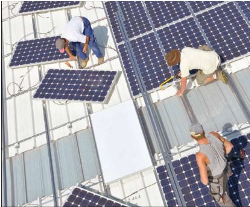
Les panneaux de l'entreprise Didelon au Poiré-sur-Vie peuvent fournir en électricité 135 logements.
