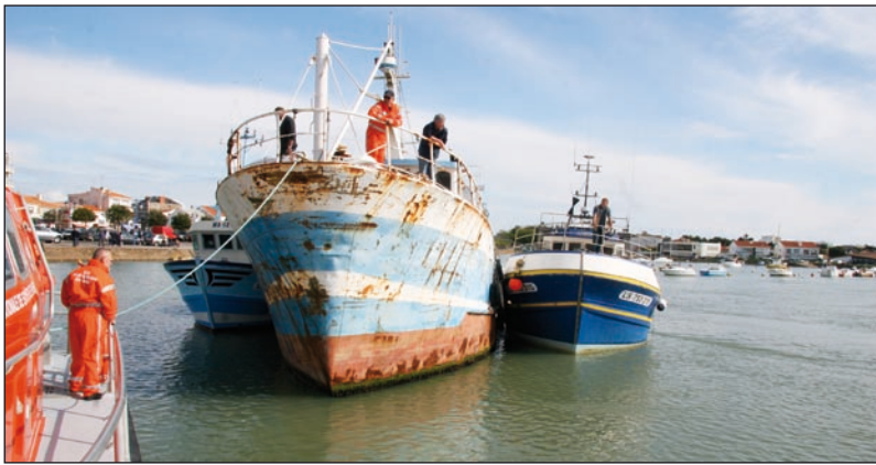
Le Conseil général de la Vendée s'est substitué au propriétaire du « Méfi » pour procéder rapidement et efficacement à sa démolition.
