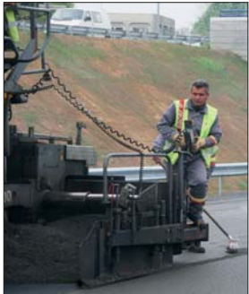
Les cent derniers mètres du contournement Nord ont été réalisés à partir d'un enrobé avec revêtement végétal.
