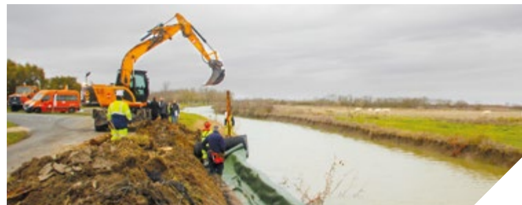
L'entretien des routes est une priorité en Vendée, notamment en ce qui concerne les routes de marais où les voiries se dégradent plus vite pour diverses raisons: sol, sécheresse...
