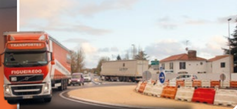
Depuis le 30 novembre, un nouveau giratoire a été construit au lieu-dit Les 4 chemins de l'Oie (Essarts-en-Bocage). Il remplace les feux tricolores pour plus de fluidité du trafic et plus de sécurité. Ce carrefour est emprunté par plus de 2500 poids lourds en moyenne par jour.
