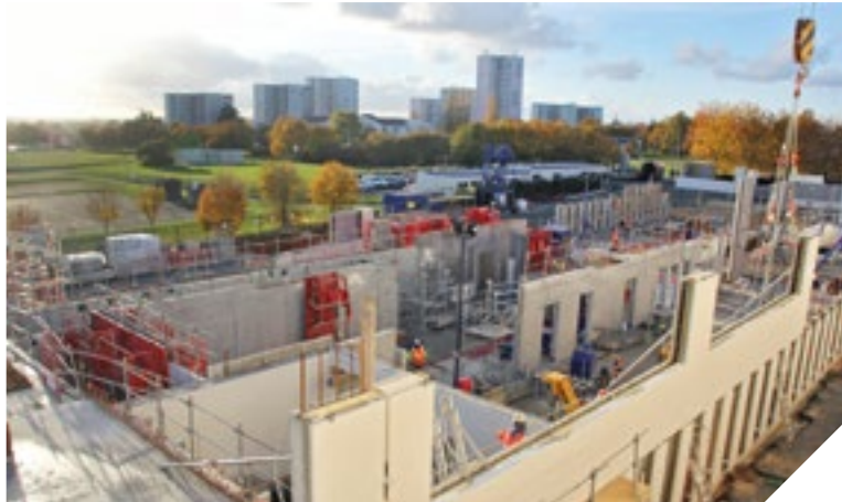
Le nouveau bâtiment comprendra plus de 30 salles de cours, un centre de documentation et d'information, un foyer des élèves, une salle des professeurs, un restaurant scolaire...
