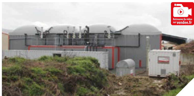
L'unité de méthanisation du GAEC des Vallons à Menomblet.
