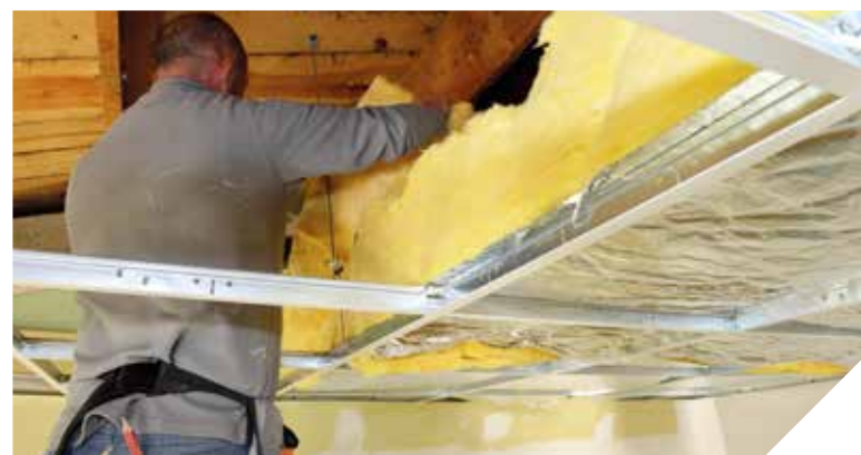
Le SyDEV encourage les collectivités à entreprendre des travaux de rénovation thermique.
