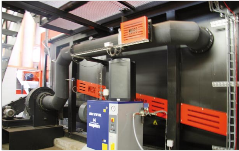
Une des chaufferies mises en place chez Piveteau.
