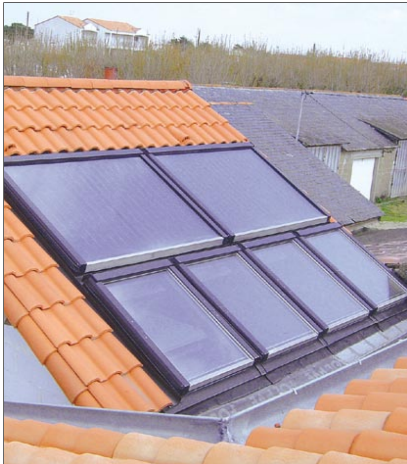
Les capteurs solaires vont permettre aux locataires de logements sociaux d'économiser 140 euros par an.
