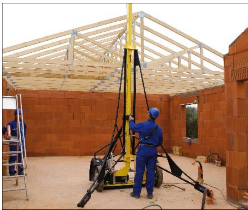
Le lev'charpente permet de monter des charpentes sans difficultés et en toute sécurité, tant pour les ouvriers que pour le matériel.
