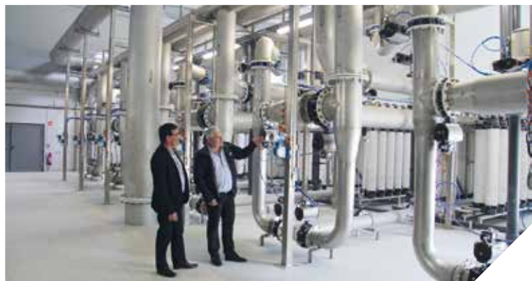
Cet espace de l'usine est dédié à la technique de l'ultrafiltration.
